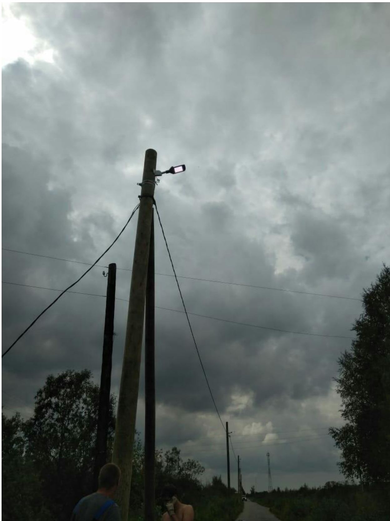
Фотография подключенной линии электропередач
